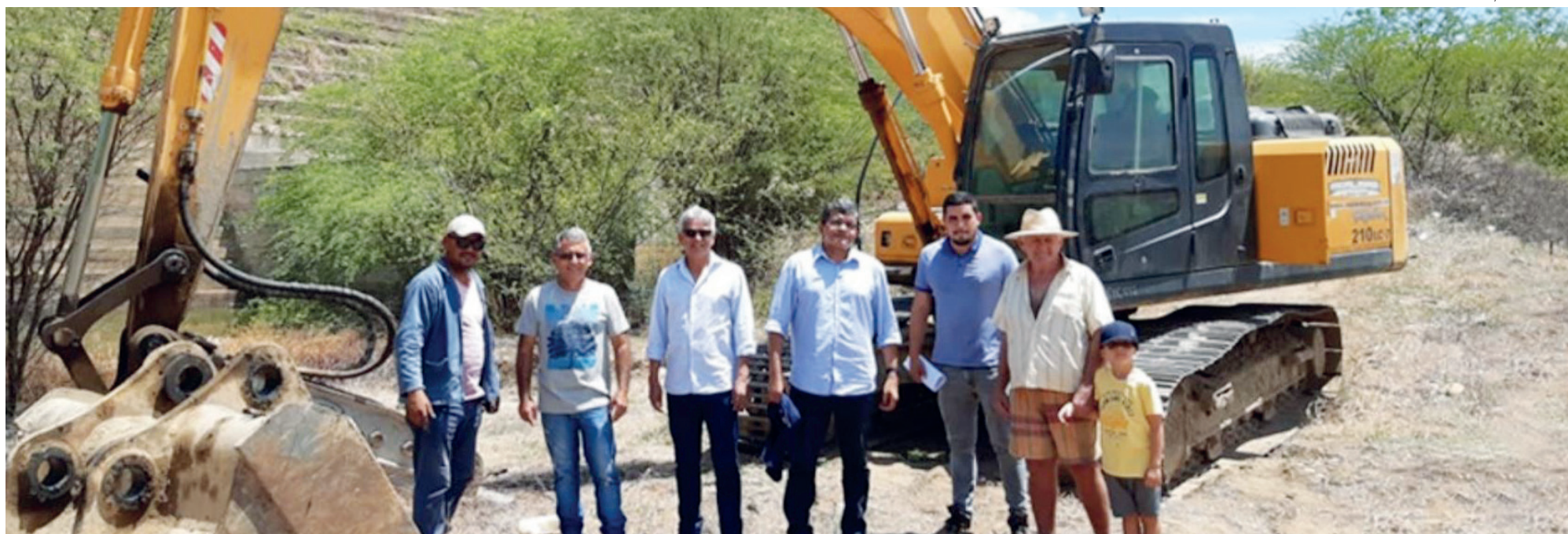
Visita técnica foi feita no dia 15 deste mês. O secretário João Maria Cavalcanti foi acompanhado do adjunto da pasta, Carlos Nobre, para acompanhar o início das obras emergenciais da abertura da fenda na barragem
