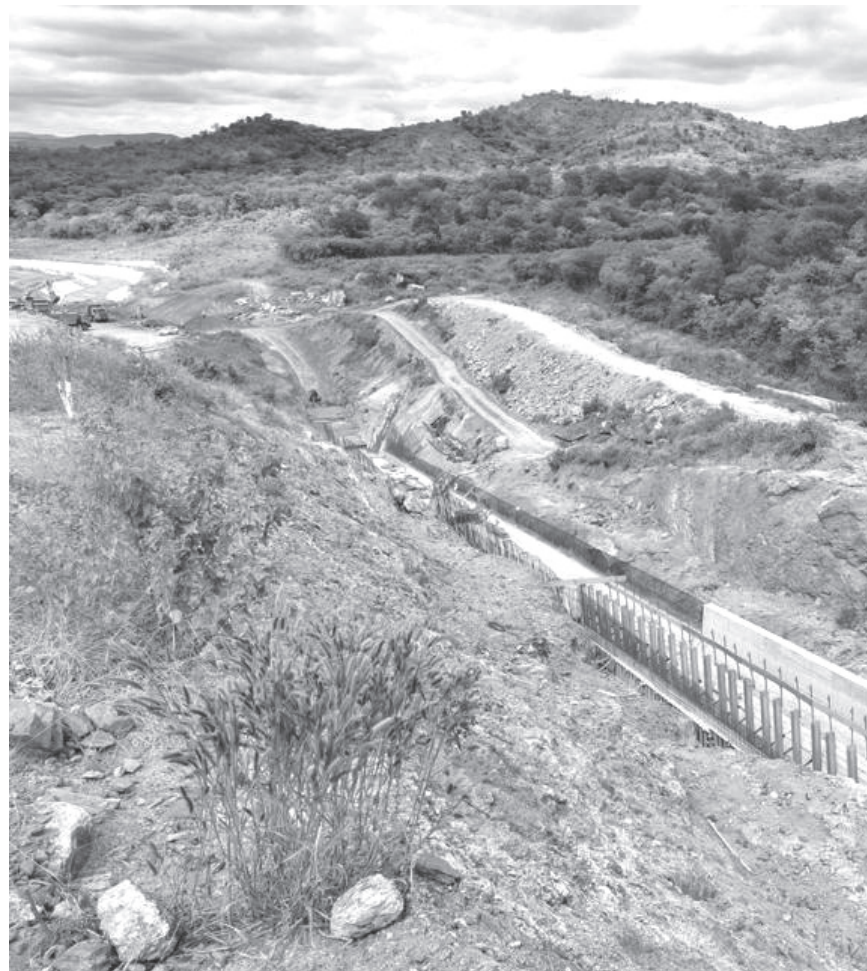
Eixo Norte é formado por 5 trechos de obras, e espera-se que 200 mil potiguares sejam beneficiados. In
