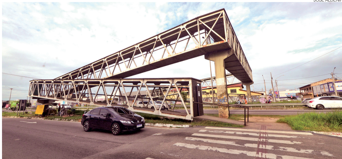
Local segue interditado aguardando manutenção; enquanto isso, pedestres precisam se arriscar em meio ao trânsito
