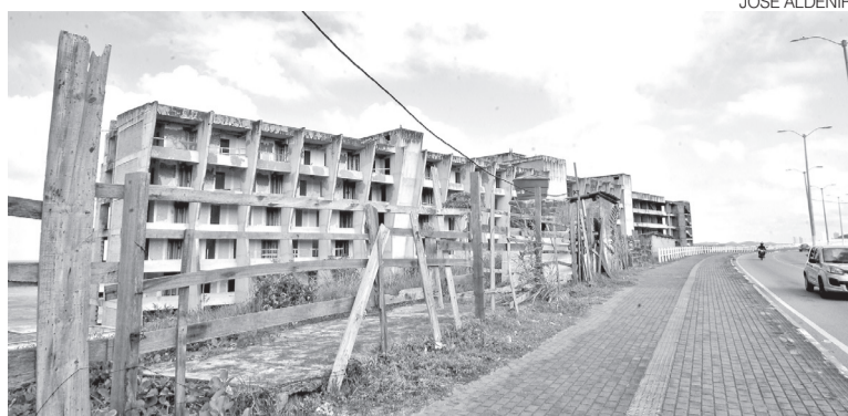
Em 2017, Justiça condenou NATHWF a demolir o pavimento excedente
