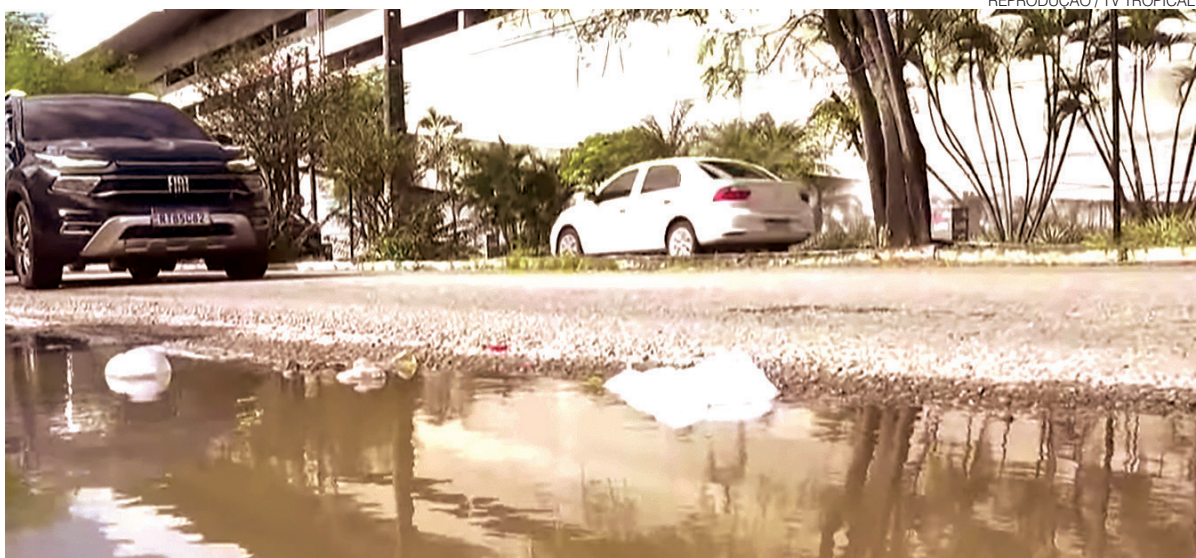
Comerciantes dizem que vazamento persiste há cerca de seis meses e cobram providências para solucionar o problema
