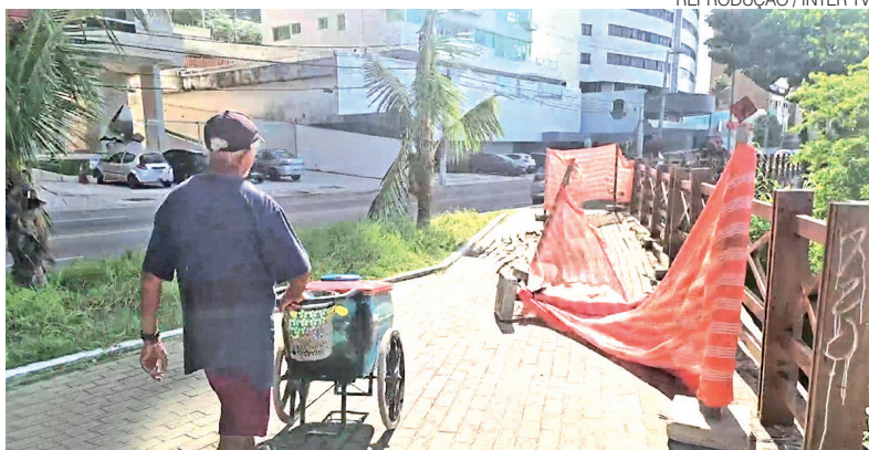
Trecho do calçadão de Areia Preta segue interditado após danos na estrutura
