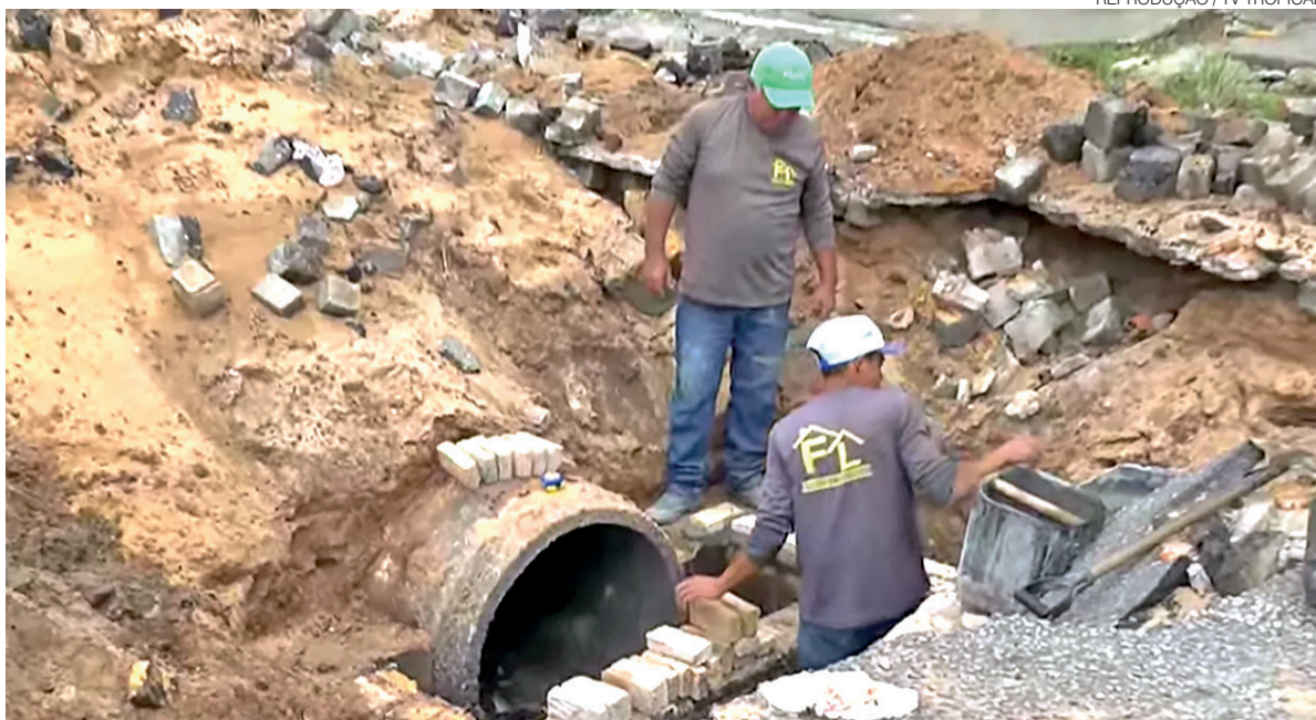
Rompimento de uma tubulação da rede de drenagem abriu uma cratera na Rua Leão Veloso, no bairro do Alecrim
