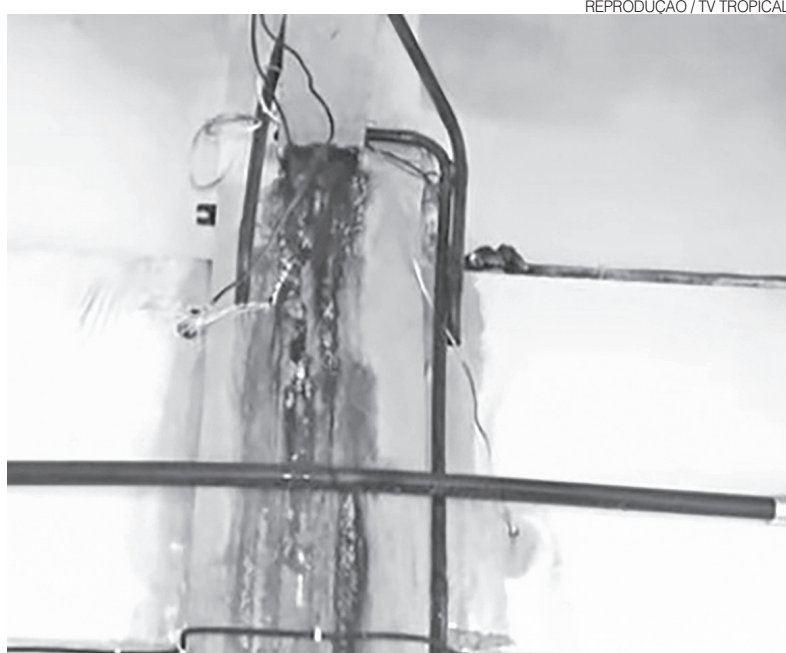
Infiltrações provocadas pelas chuvas levam à suspensão de aulas em escola
