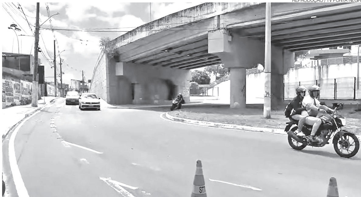
Afundamento próximo ao Viaduto da Urbana surgiu após o período de chuvas registrado na capital na última semana
