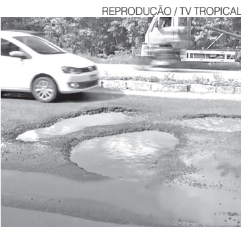
Buracos se multiplicam na avenida
