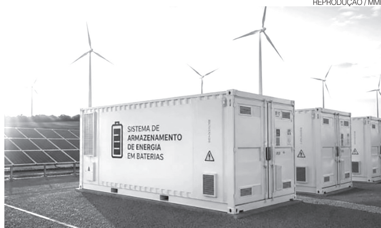
Armazenamento vai gerar investimentos evitar cortes na produção de energia
