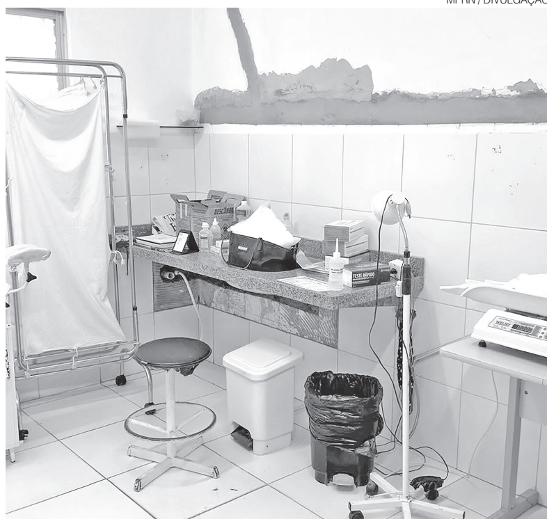
Entre os problemas apontados estão infiltrações, mofo, falha em vedação
